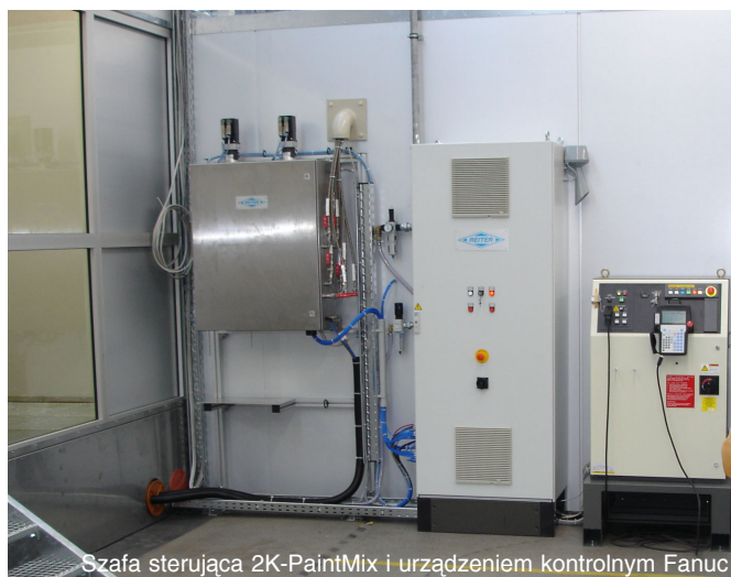
Stacja zasilania lakierem
