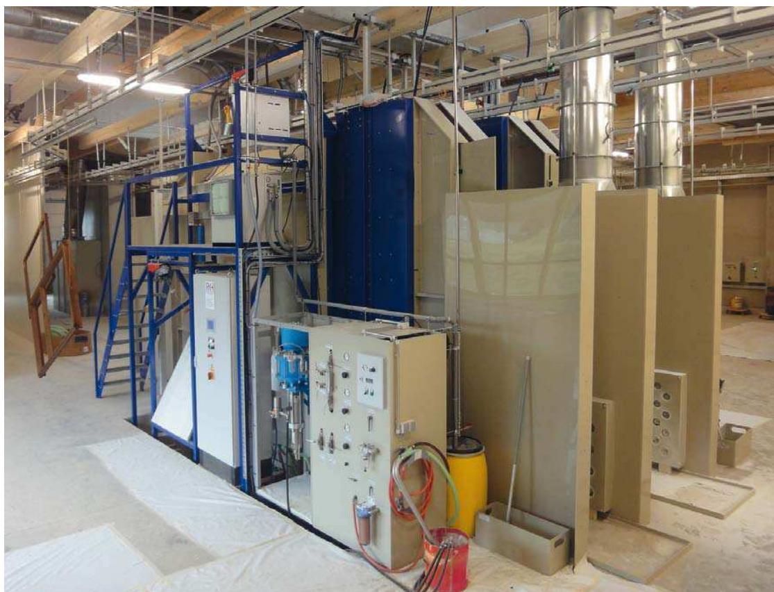
Fotografia: zamontowane urządzenia dynflow
